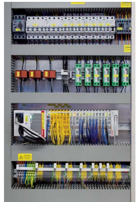
Blick in den Schaltschrank: Ein Embedded-PC steuert in Verbindung mit den EtherCAT- und TwinSafe-Klemmen den Verpackungsablauf der Schlauchbeutelmaschine.
