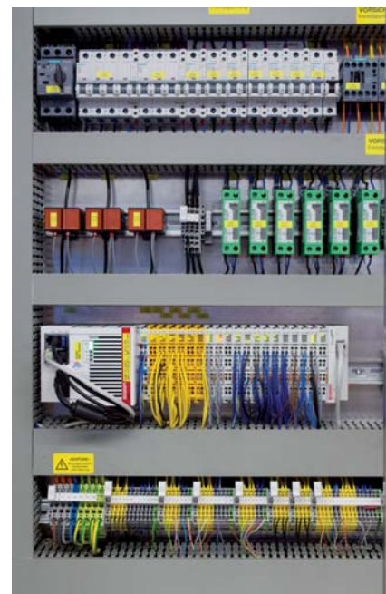
Blick in den Schaltschrank: Ein Embedded-PC steuert in Verbindung mit den EtherCAT- und TwinSafe-Klemmen den Verpackungsablauf der Schlauchbeutelmaschine.
