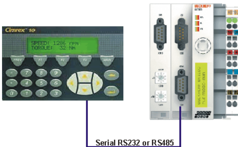
Abb. 121: Cimrex-Panel am COM-Port des BX-Controllers
