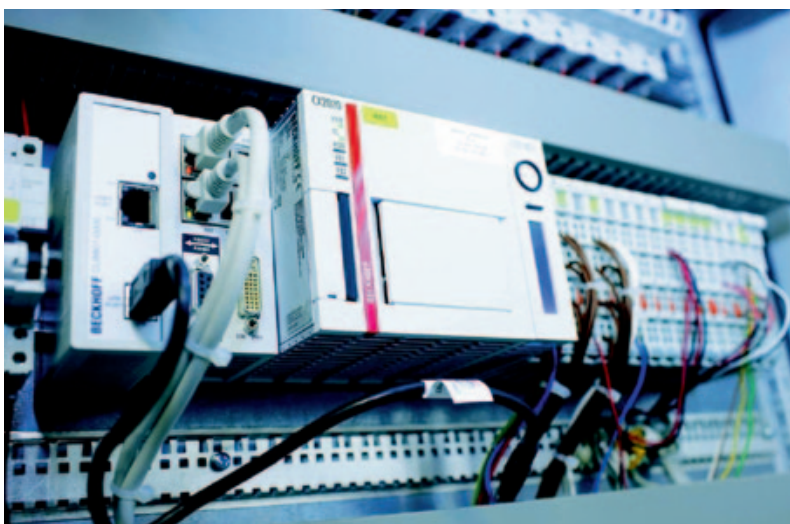
In insgesamt fünf Etagen-Schaltschränken sorgt je ein Embedded-PC „CX2020“ mit Intel-Celeron-CPU und 1,4 GHz Taktfrequenz zusammen mit einer Vielzahl an Busklemmen für die Verarbeitung von rund 15.000 BACnet-Objekten und 620 EnOcean-IDs (Alle Abb. Beckhoff).
