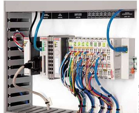
Der Beckhoff-Embedded-PC CX1010 mit TwinCAT-NC-PTP-Software steuert den kompletten ARC-11-RB-Schweißvorgang.
