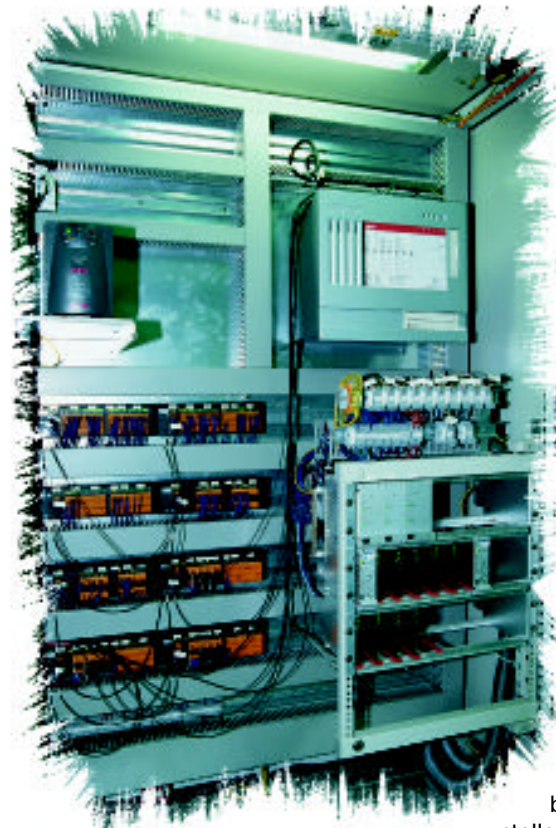
Im Schaltschrank sitzt der PC in industriege-rechter Ausführung
