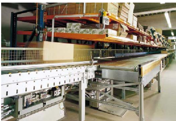
Все приводы связаны с управляющими промышленными ПК посредством шинных модулей ввода-вывода по шине Lightbus от компании Beckhoff
