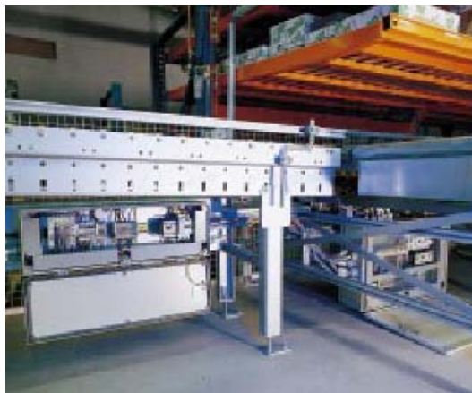
Один шкаф управления полностью отвечает за работу каждого транспортного узла. Достоинством такого подхода является высокая гибкость при изменении структуры или расширении объекта управления. Для отключения модуля контура, и транспортного модуля соответственно, достаточно отключить всего лишь шесть кабелей.
