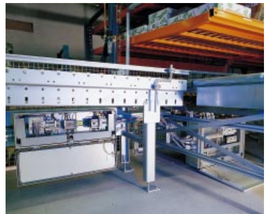
Je ein Schaltkasten ist für eine Fördereinheit verantwortlich. Die Lösung hat den Vorteil einer hohen Flexibilität beim Umbau der Anlage. Lediglich sechs Kabel müssen umgeklemmt werden, um das Schaltmodul und damit das Fördermodul auszuklinken.
